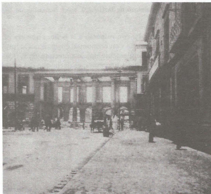
Fachada. Gran Teatro Nacional. Demolición. Enero-julio 1901. Díaz y de Ovando, Clementina. "El Gran Teatro Nacional baja el telón. 1901". en "La Destrucción del Arte Mexicano". Revista de la UNAM. julio 1989. núm. 462.
