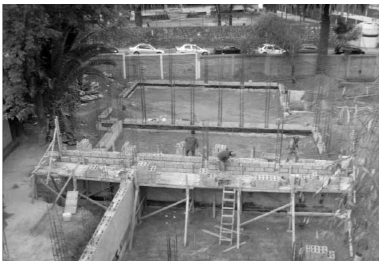
Proceso de construcción en 2011-2013 de las nuevas instalaciones inauguradas en 2013. Fotógrafo: Guillermo Israel González Sánchez
